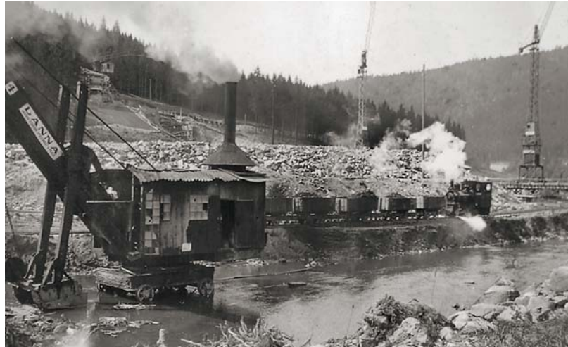
Ve třicátých letech 20. století byly při výstavbě přehrad běžně používány úzkorozchodné dráhy. Jedna z nich se uplatnila i při výstavbě přehradní hráze na řece Teplé v Březové u Karlových Varů (1931 – 1935). Foto: archiv Povodí Ohře
