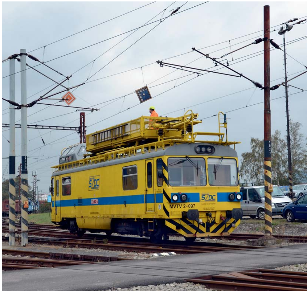
Údržbu trolejového vedení v SOKV Ústí nad Labem zajišťuje Správa železnic.
