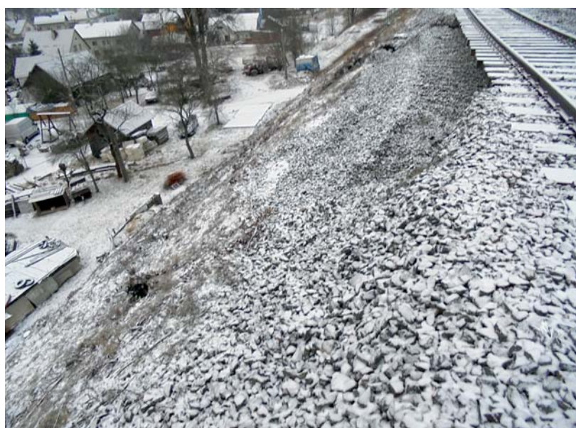
Nestabilní násep mezi Valašskou Polankou a Horní Lidčí Foto: Správa železnic
