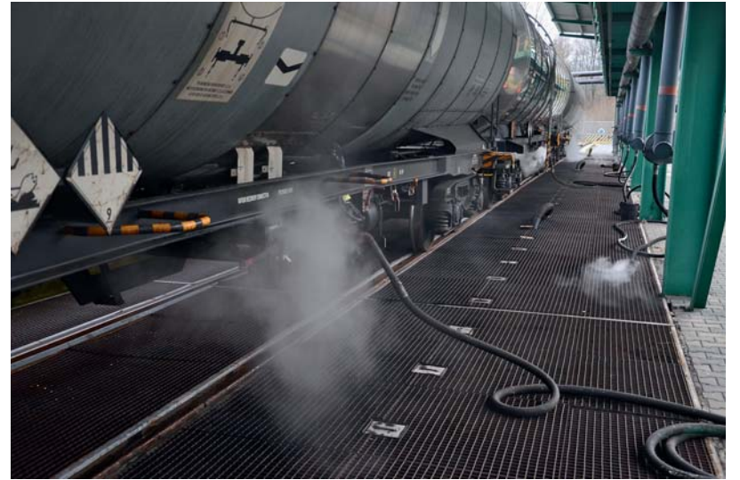
Před vykládkou je nutné ventily na vozech nahřát.
