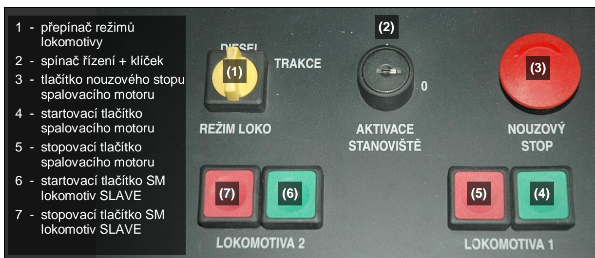
obr. 4: Spínač řízení, startovací a stopovací tlačítka spalovacího motoru
