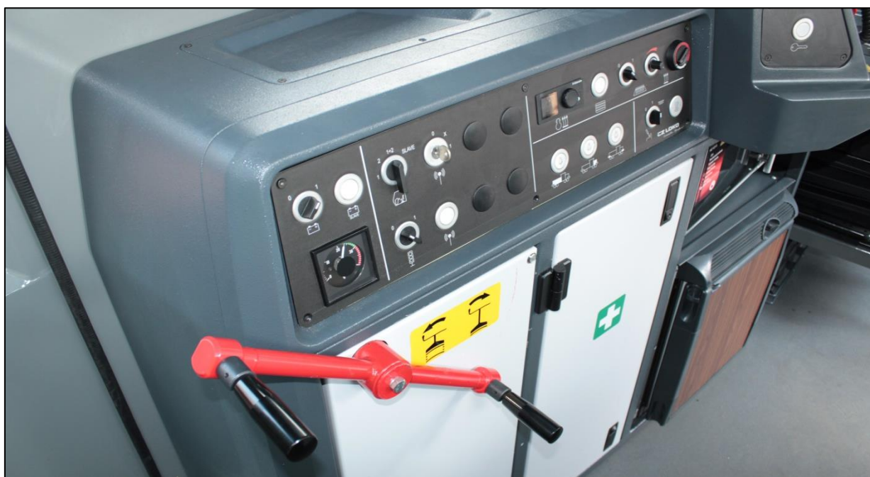
obr. 11: Panel elektrického rozváděče R2
