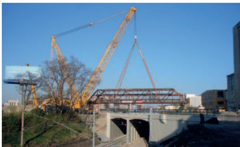
V popředí je vidět nově vybudovaný železobetonový most přes chebskou trať. Zanedlouho po tomto novém mostě budou jezdit vlaky do Domažlic. Vlaky do Chebu zde prozatím jezdí jednokolejně a bez trakčního vedení. Tato stavění mimořádnost na trati si již vyžádala několik utržených sběračů hnacích vozidel ČD i ČD Cargo. Foto: Jaromír Ott
