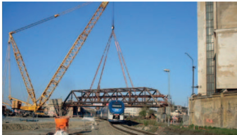
Přibližně pět hodin před snesením Faltusova mostu. Na snímku Jaromíra Otta je jeden z posledních vlaků Českých drah projíždějících pod tímto unikátním mostem (Os 7424 z Plzně do Domažlic)
